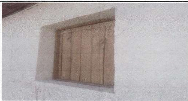
Foto 5: Ventana Valconeada cocina E.O.R.M Aldea Cabajchun
