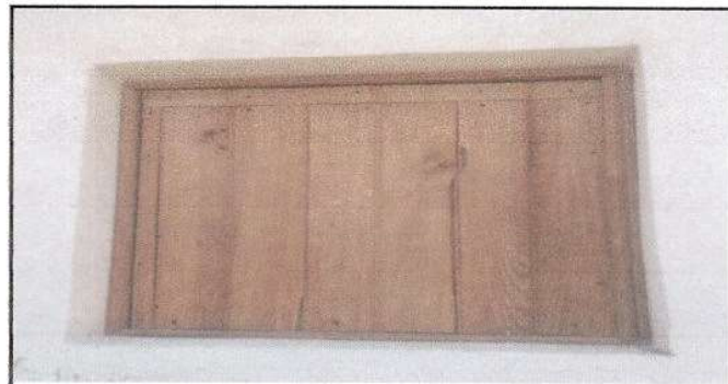
Foto 6: Ventana Valconeada cocina E.O.R.M Aldea Cabajchun
